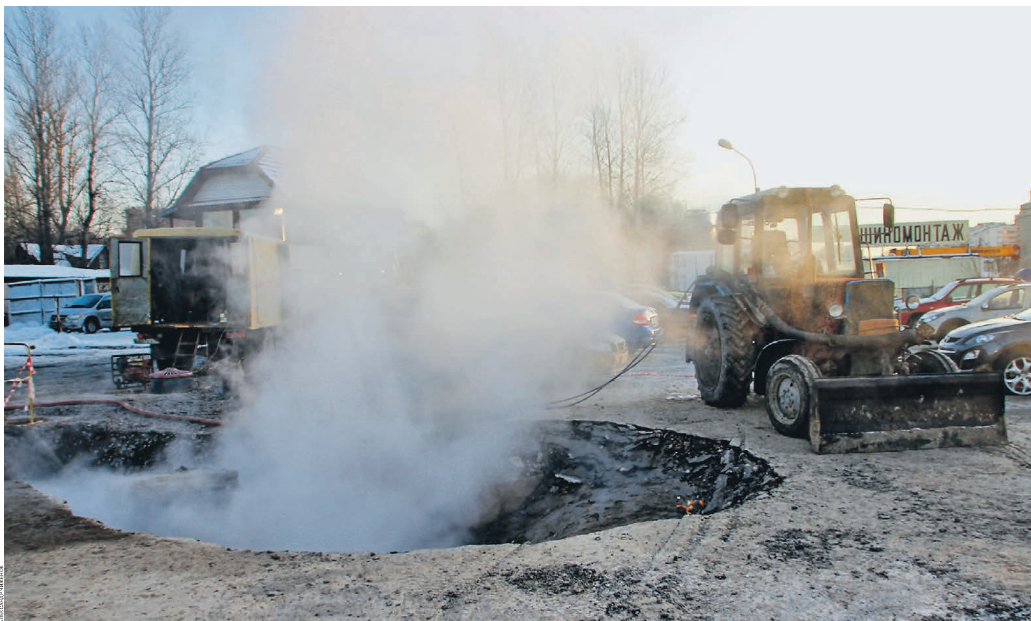
Накопление износа теплосетей в российских муниципалитетах приводит к коммунальным авариям
