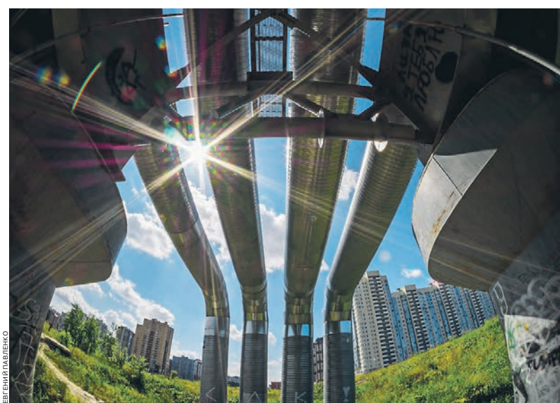
Минэнерго подготовило нормативную базу для пилотных проектов альтернативной котельной
