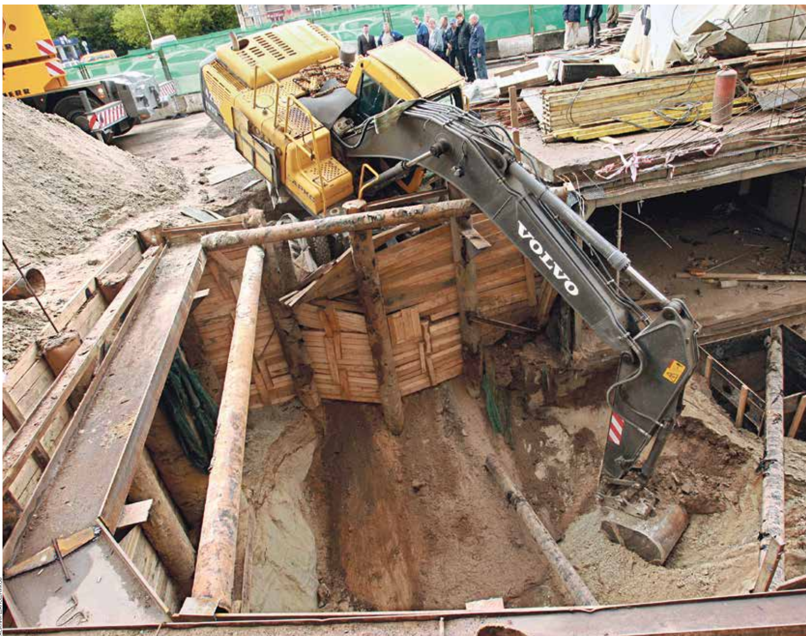
Основным и главным способом предотвращения аварийных ситуаций при подземном строительстве является надлежащее проведение геологических изысканий перед проведением работ
