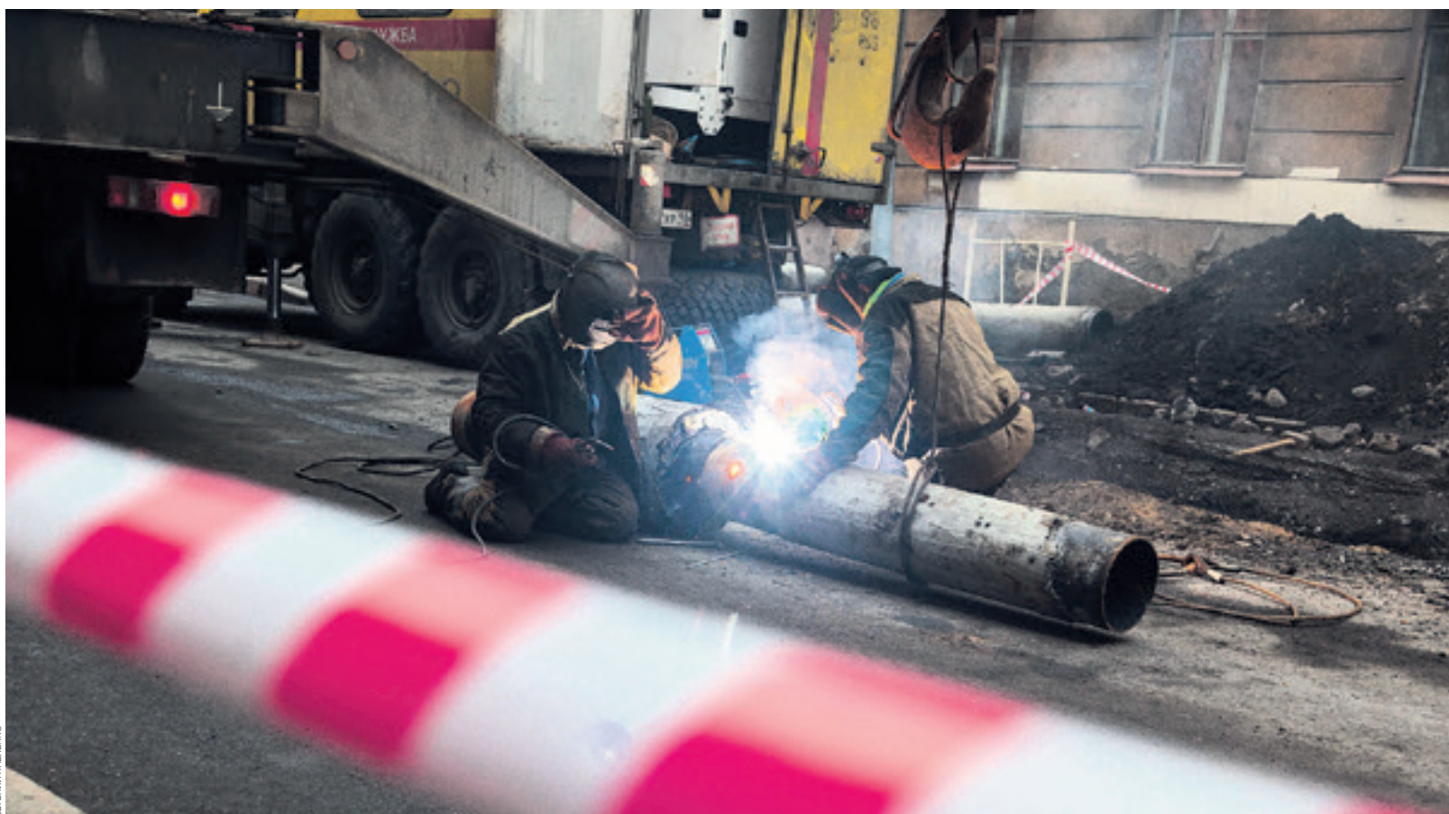
По экспертным оценкам, более 60% оборудования генераций выработало свой ресурс и потребует замены в ближайшие годы
